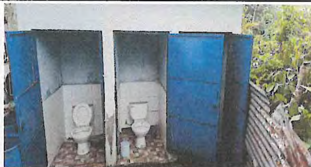
Foto 4: Sanitario en mal estado.
