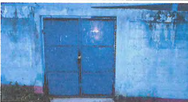
Foto 3: Porton en mal estado
