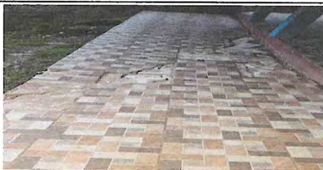
Foto 5: Piso en mal estado.
