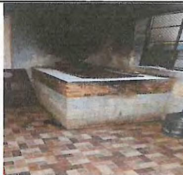
Foto 2: Cocina en mal estado.
